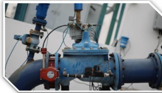
Válvulas reductoras de presión
