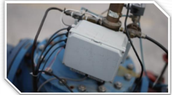
Controladores, entre otros
